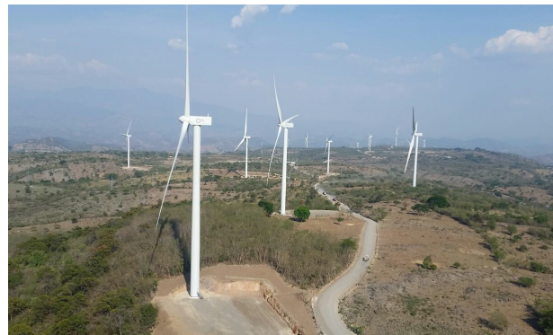
Transmisión de Electricidad 27 - 04 - 2018
